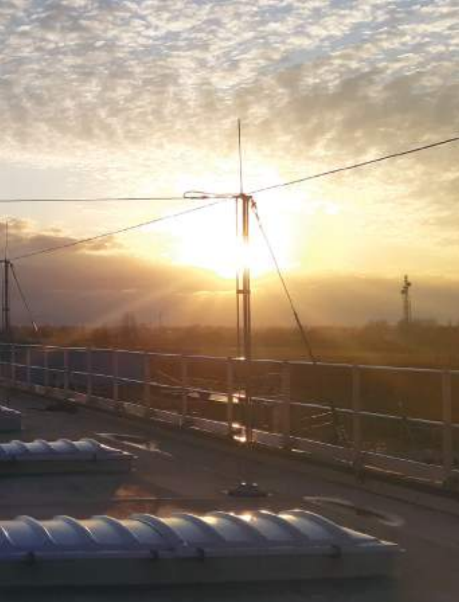
7 : La foto mostra un LPS a fune a protezione di un impianto fotovoltaico ubicato sul coperto della struttura. Le funi sono ancorate al tetto tramite supporti isolati a "V" i quali, oltre a garantire il rispetto della distanza di sicurezza nei confronti degli elementi metallici della struttura, sono utilizzati come elementi di ancoraggio per il tensionamento della fune stessa. "Si ringrazia la Ditta Milani S.p.A. per la foto".
